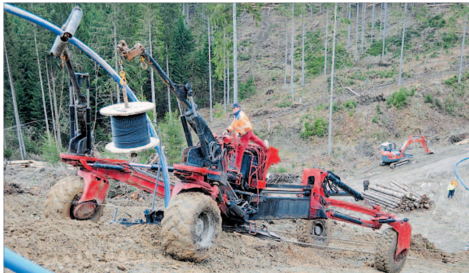
Im unwegsamem Gelände fühlen sich die schweren Kabelpflüge des IHK-Gründerpreisträgers Föckersperger GmbH besonders wohl. Foto: oh
